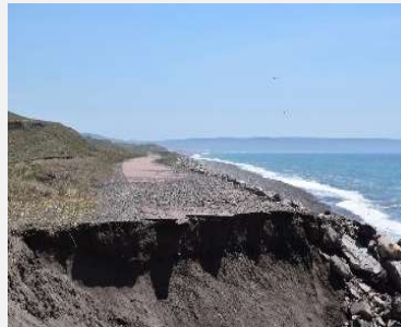
Deux brèches sur la route de l'isthme du fait de l'érosion hivernale en 2021, coupant l'axe de communication. Photo de gauche : les enrochements posés en appoint ont été démantelés par la mer et utilisés comme projectiles, aggravant l'érosion. Photos : X. Philippenko, été 2021.
