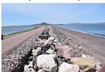
Plusieurs lignes de protection renouvelées tous les ans pour la route de Mirande et visibles depuis la mer
