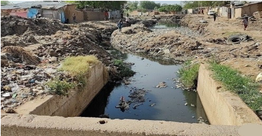
Photo.18 : Canal de Ridina réduit en décharge à ciel ouvert au cœur du 5 ème arrondissement, Cliché : Djabaye 2023
