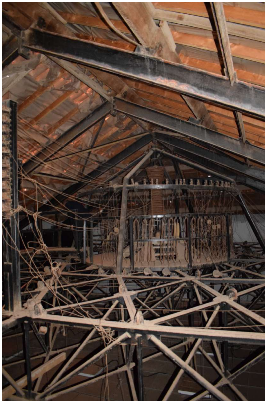
Figure 87 - Institut National d'Art dramatique (1964-1967). Gril du théâtre d'essai. Structure tridimensionnelle et machinerie. Photo prise par l'auteur.
