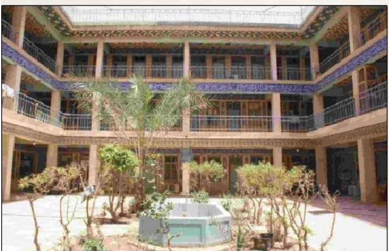
Figure 197: La cour de la Madrasa al- Ākhūnd al-Kubra avant et pendant les travaux (Auteur, Dewan)
