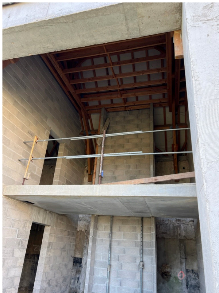
Figure 110: Travaux de consolidation du mur d'enceinte depuis l'intérieur de la friche (M. Jussaume, 2023)
