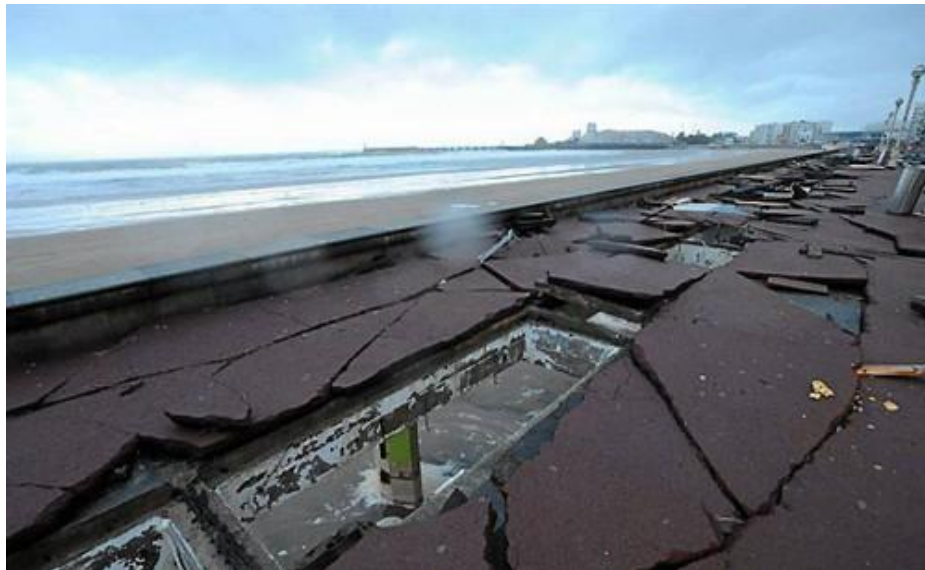
Figure 3.61. Promenade du Remblai, Sables d'Olonne, après Xynthia (source : Ouest-France)
