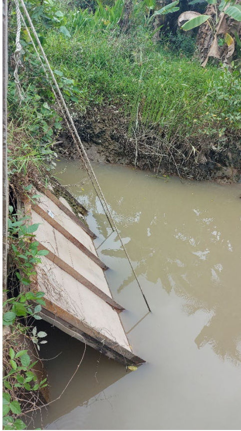
Figure n°53 : Ecluse publique dysfonctionnelle dans la commune de Long Định, district de Bình Đại, province de Bến Tre. Source : photographie de l’auteure, avril 2022.
