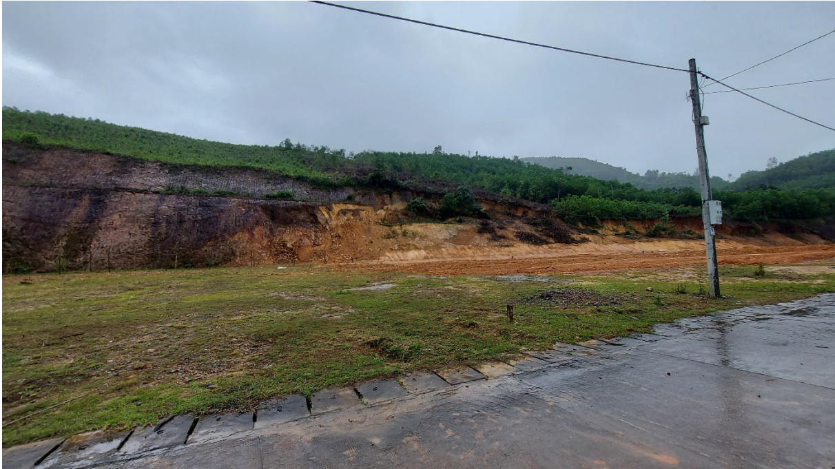
Figure n°60 : Falaise affectée par un glissement de terrain et aplanie sur un site d'accueil d'une opération de relogement dans la commune de Long Mai, district de Minh Long, province de Quảng Ngãi. Source : photographie de l'auteure, janvier 2022.
